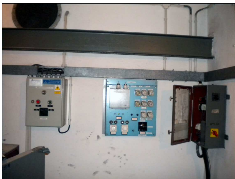
Tablica wstępna dźwigu i tablica sterowa wentylatora oddymiającego
