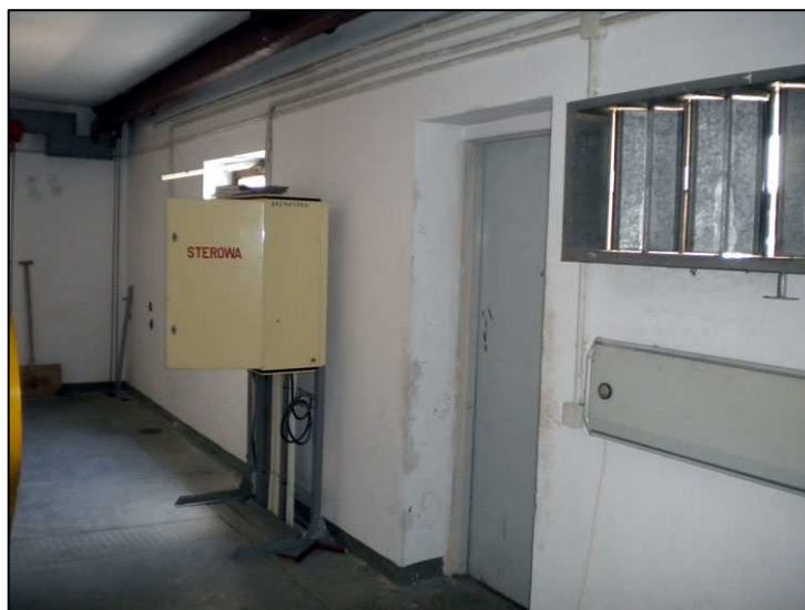
Tablica sterowa posadowiona obok wyjścia na dach obiektu
