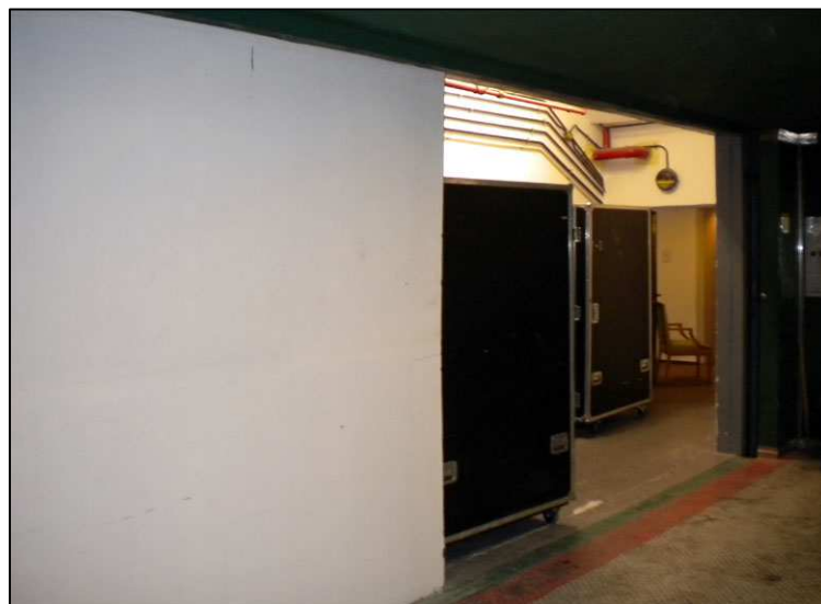
Zawężony otwór drzwiowy na przystanku „4”
