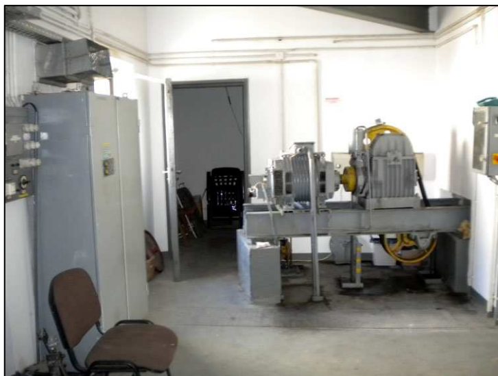
Część maszynowni z zespołem napędowym sąsiedniego dźwigu towarowego
