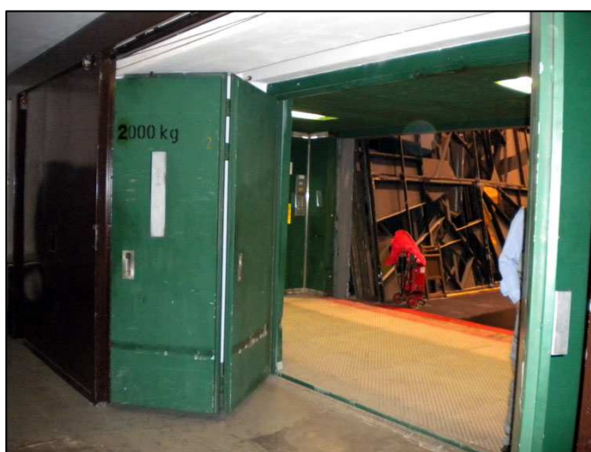
Drzwi szklane ręcznie otwierane i kurtyna przeciwpożarowa na przystanku przelotowym „2” od strony Teatru Wielkiego
