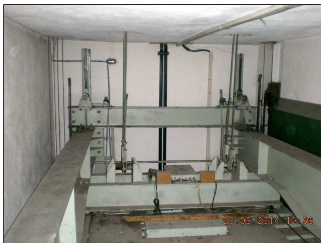
Nadszybie i rama kabinowa
