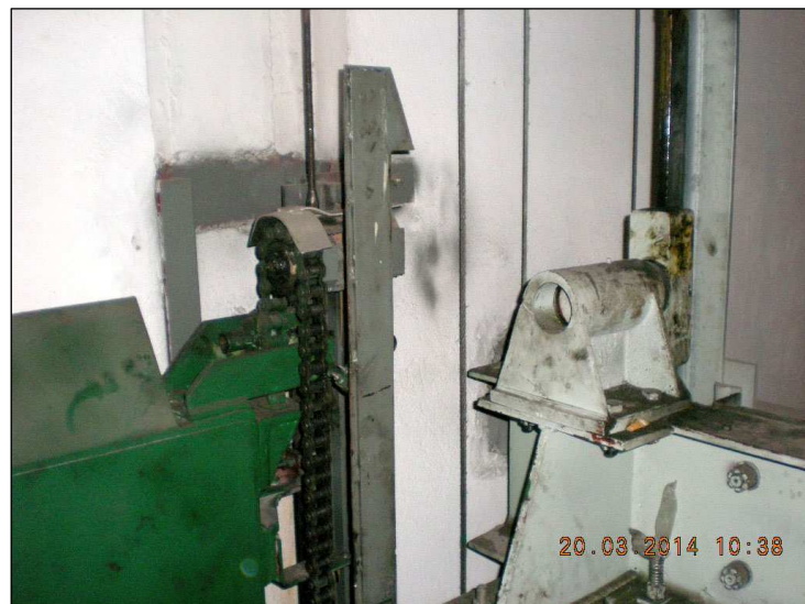
Prowadnik ramy kabinowej (żeliwny) i łańcuch napędu drzwi szybowych
