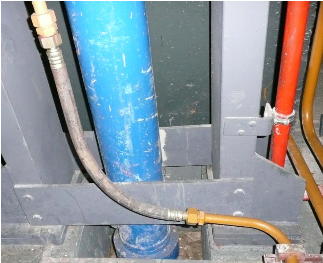
Fot. 30. Elastyczne przewody hydrauliczne cylindra podnoszenia magazynu prospektów
