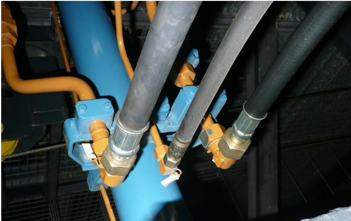
Fot. 18. Końcówki elastycznych przewodów hydraulicznych kłapy dymowej (zakończenie dolne)
