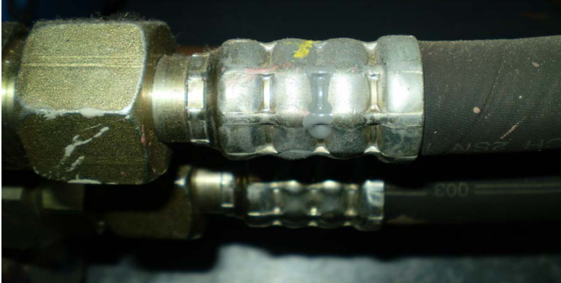
Fot. 20. Końcówki elastycznych przewodów hydraulicznych mechanizmu pochylecia platformy (zakończenie dolne)
