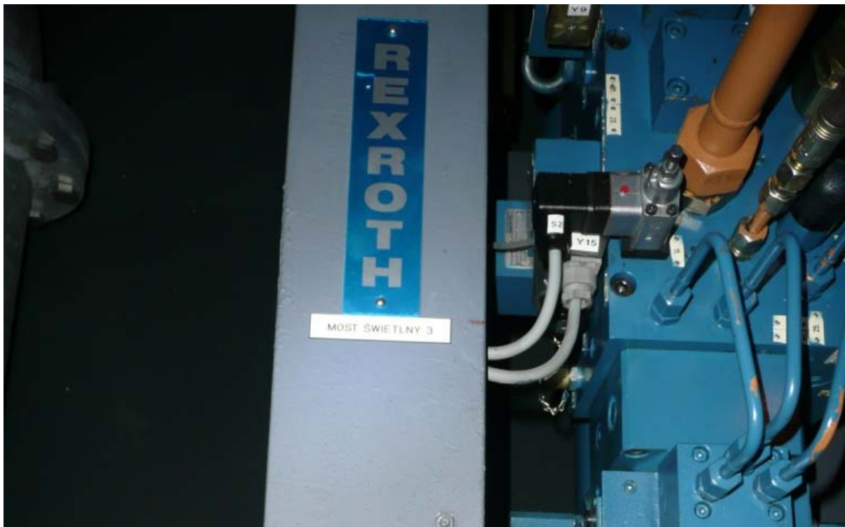
Fot. 9. Widok ogólny na przyłącza hydrauliczne mostu świetlnego 3.
