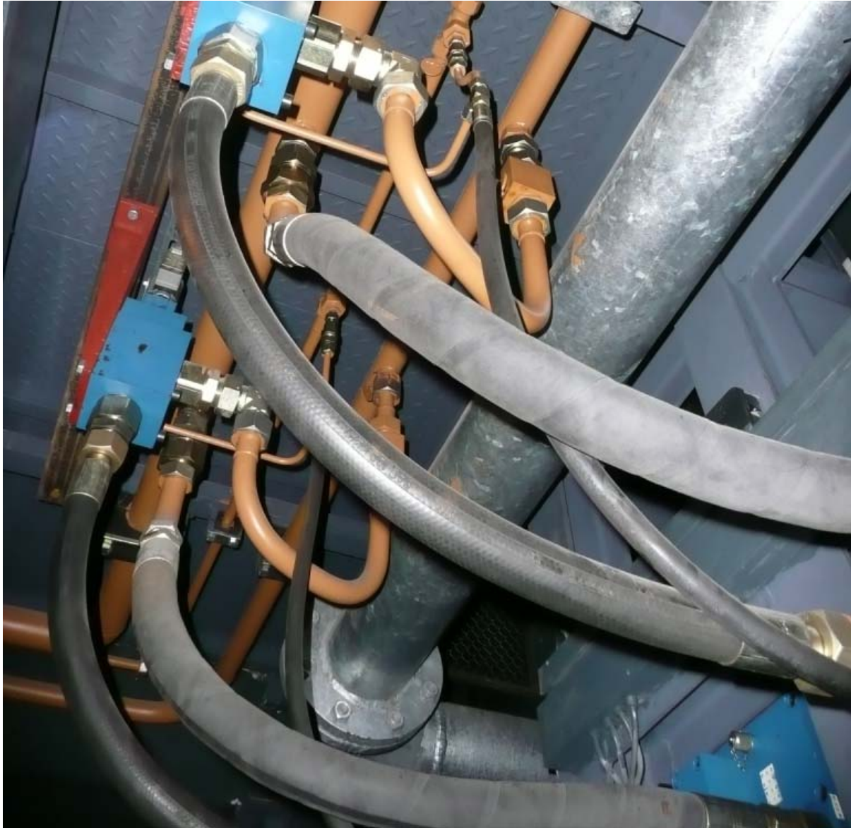
Fot. 8. Końcówki elastycznych przewodów hydraulicznych mostu świetlnego 2. (zakończenie górne)
