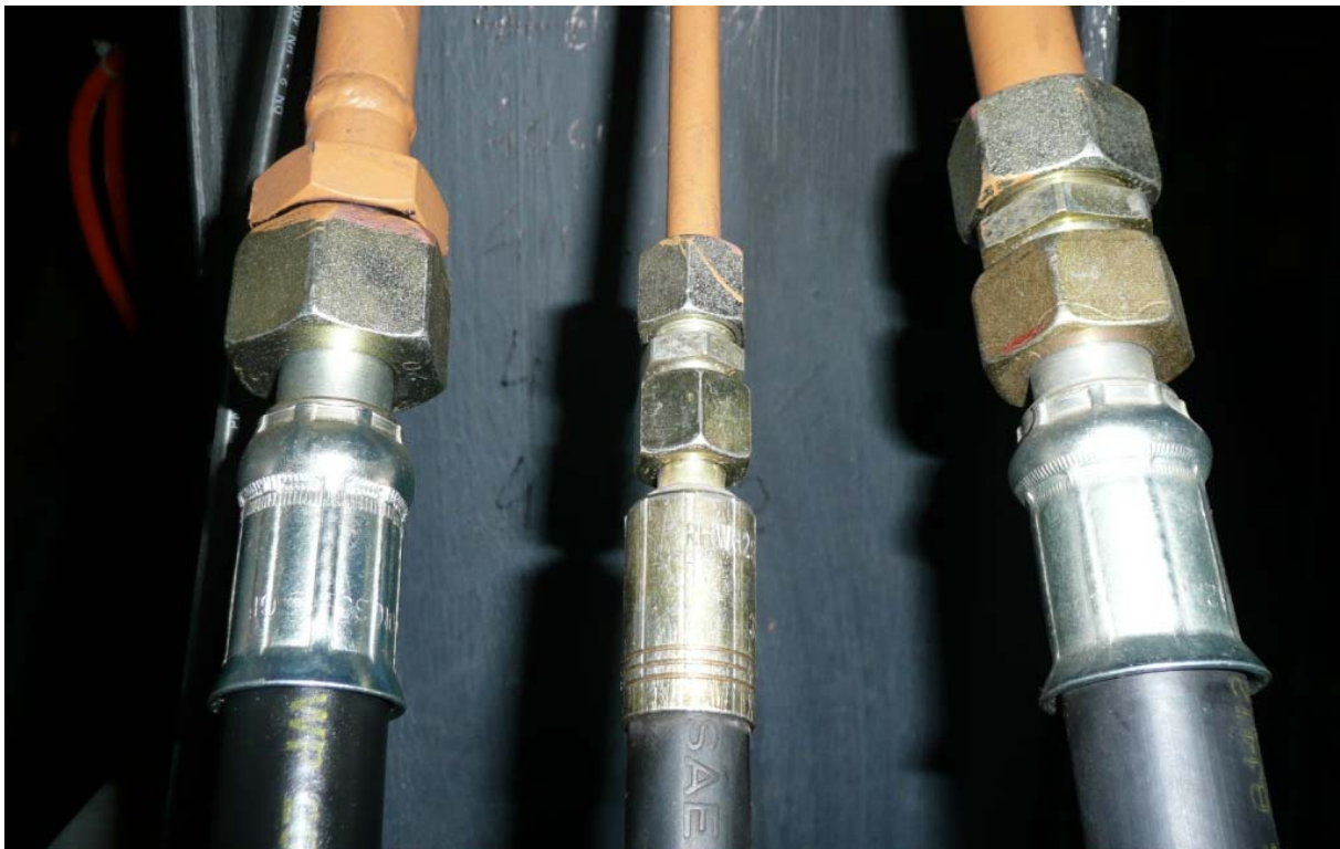
Fot. 19. Końcówki elastycznych przewodów hydraulicznych kłapy dymowej (zakończenie górne)
