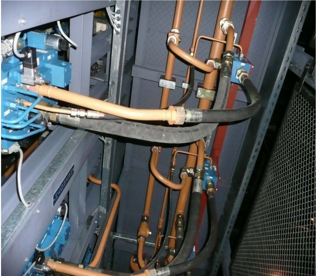
Fot. 16. Końcówki elastycznych przewodów hydraulicznych mostu portalowego (zakończenie górne i dolne)
