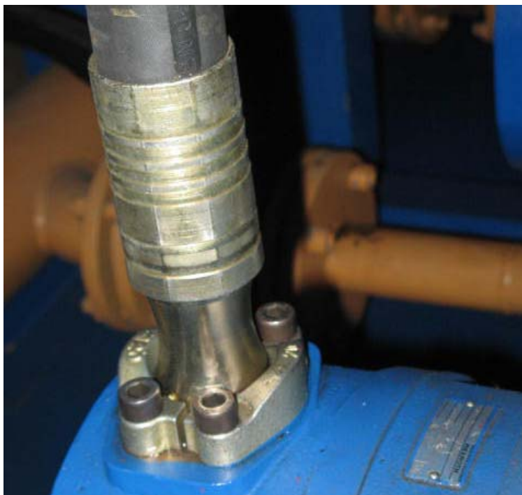
Fot. 35. Elastyczny przewód hydrauliczny ciśnieniowy wychodzący z pompy 2 - 4
