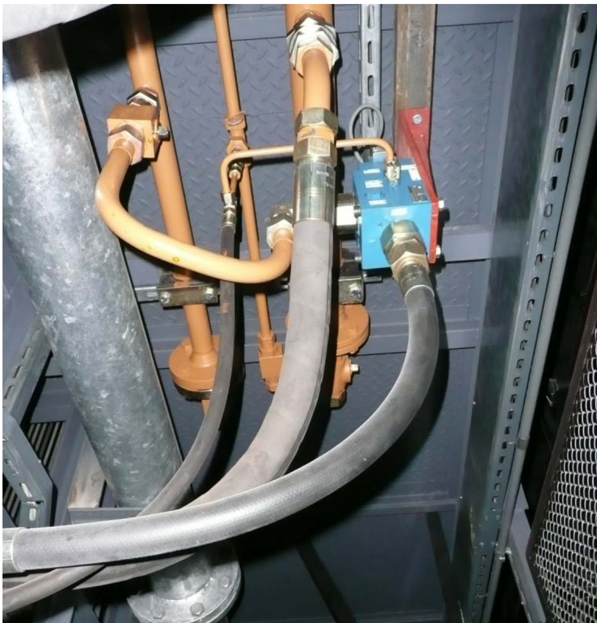
Fot. 5. Końcówki elastycznych przewodów hydraulicznych mostu świetlnego 1. (zakończenie górne)
