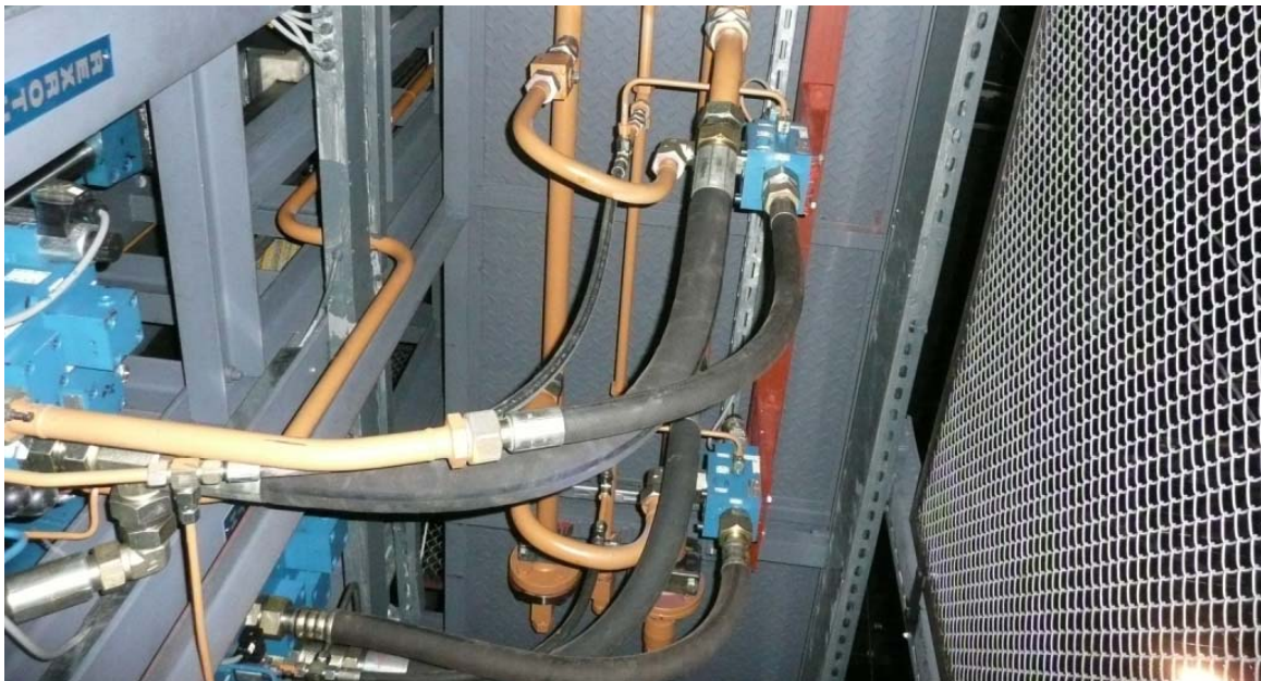
Fot. 15. Końcówki elastycznych przewodów hydraulicznych kurtyny stalowej bocznej (zakończenie górne)
