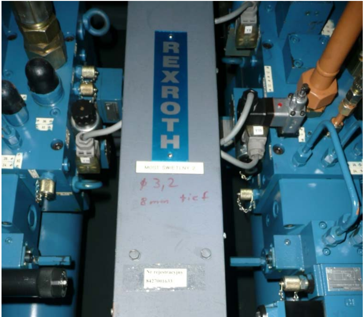
Fot. 6. Widok ogólny na przyłącza hydrauliczne mostu świetlnego 2.
