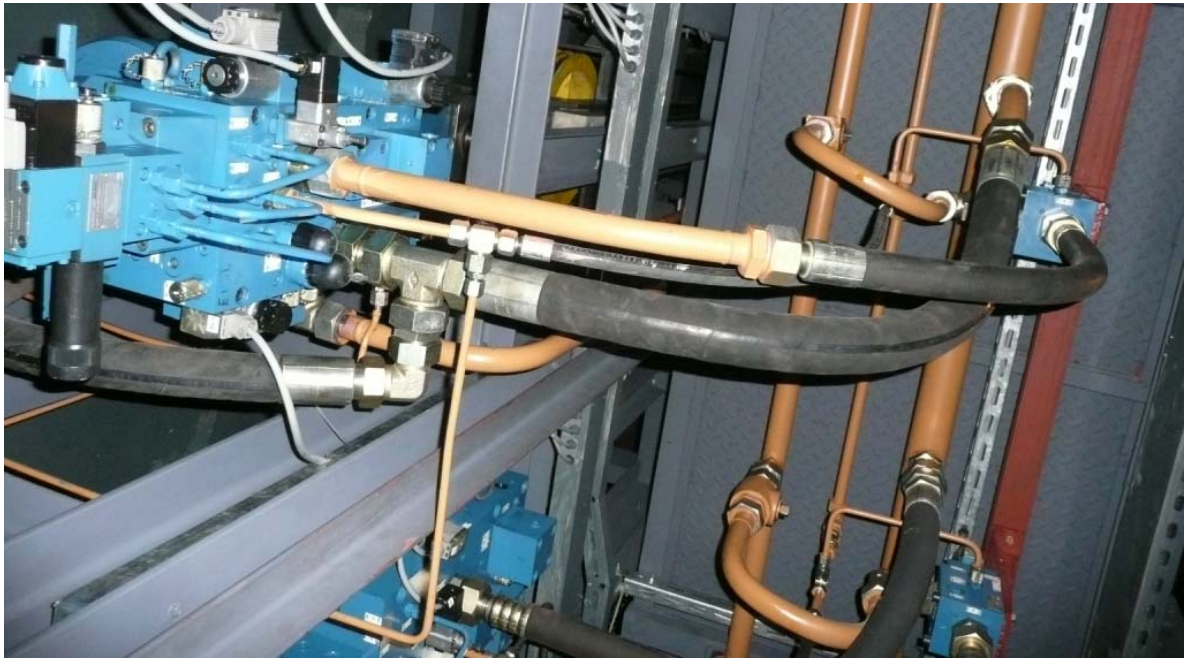
Fot. 14. Końcówki elastycznych przewodów hydraulicznych kurtyny stalowej bocznej (zakończenie dolne)
