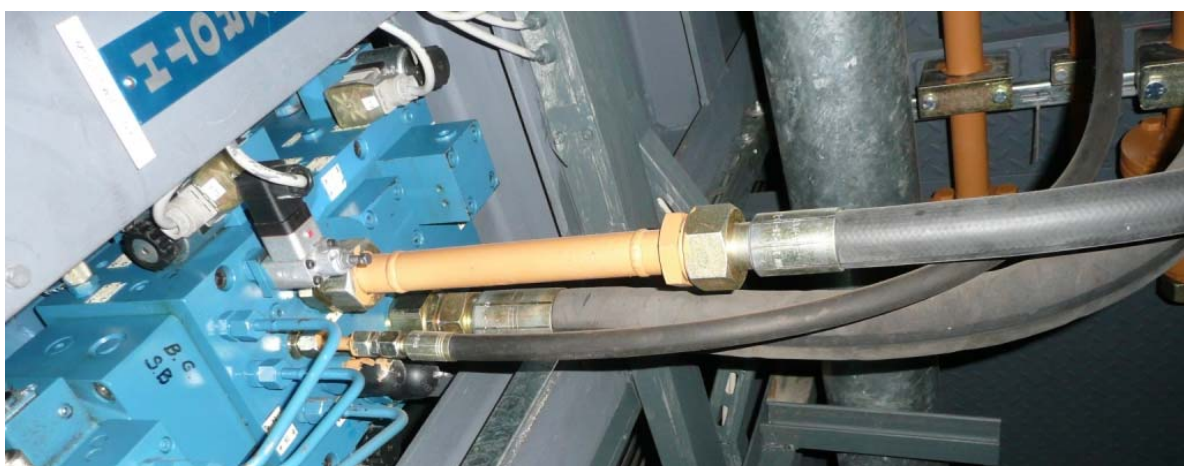
Fot. 4. Końcówki elastycznych przewodów hydraulicznych mostu świetlnego 1. (zakończenie dolne)
