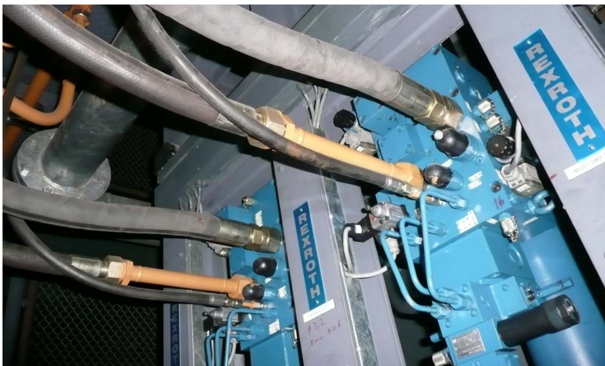
Fot. 10. Końcówki elastycznych przewodów hydraulicznych mostu świetlnego 3. (zakończenie dolne)
