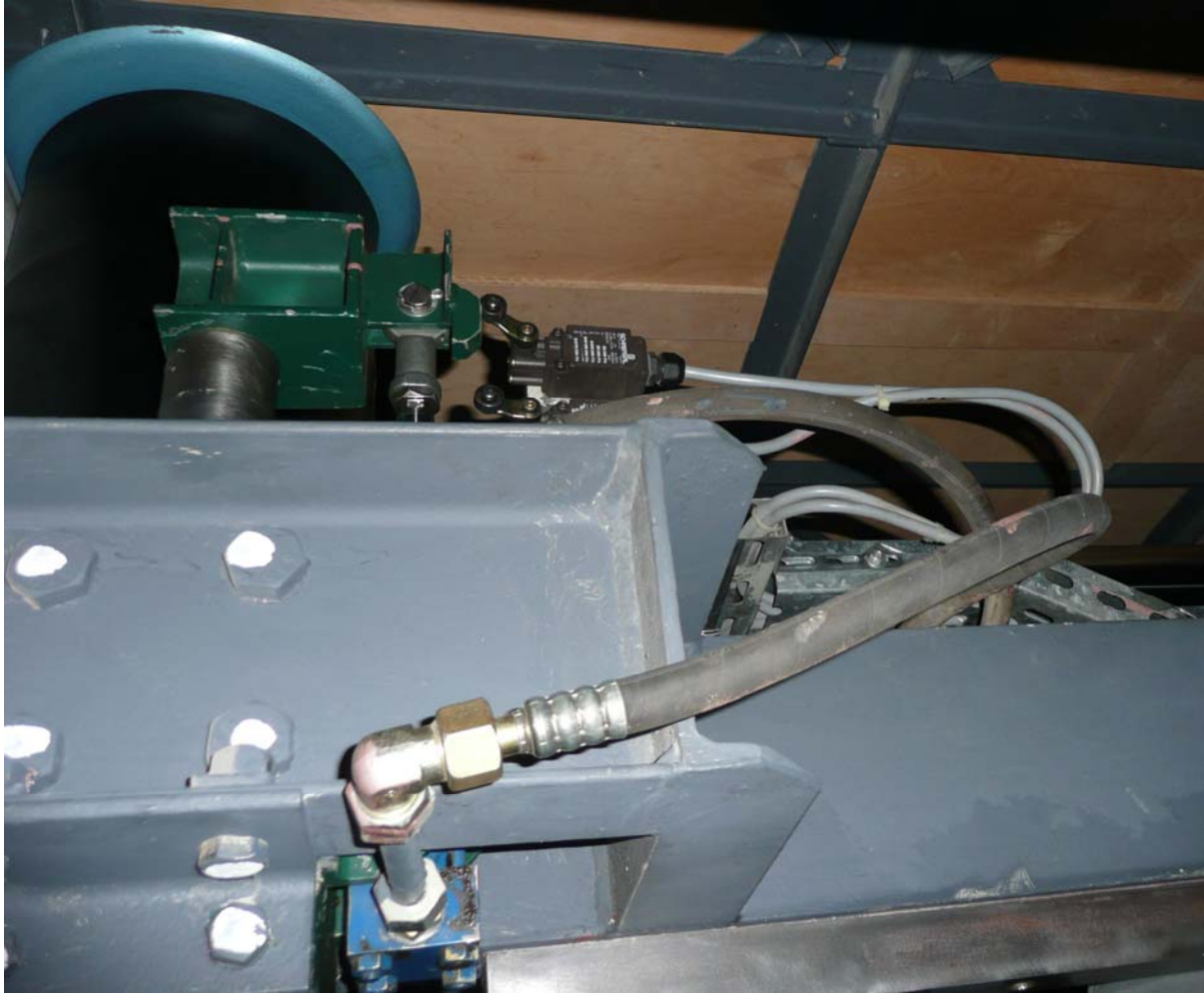
Fot. 31. Elastyczne przewody hydrauliczne cylindrów ryglujących magazynu prospektów
