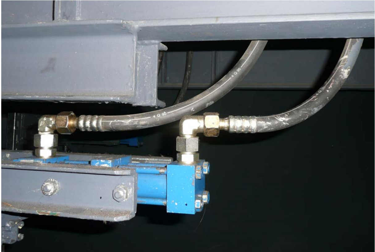
Fot. 28. Elastyczne przewody hydrauliczne cylindrów ryglujących
