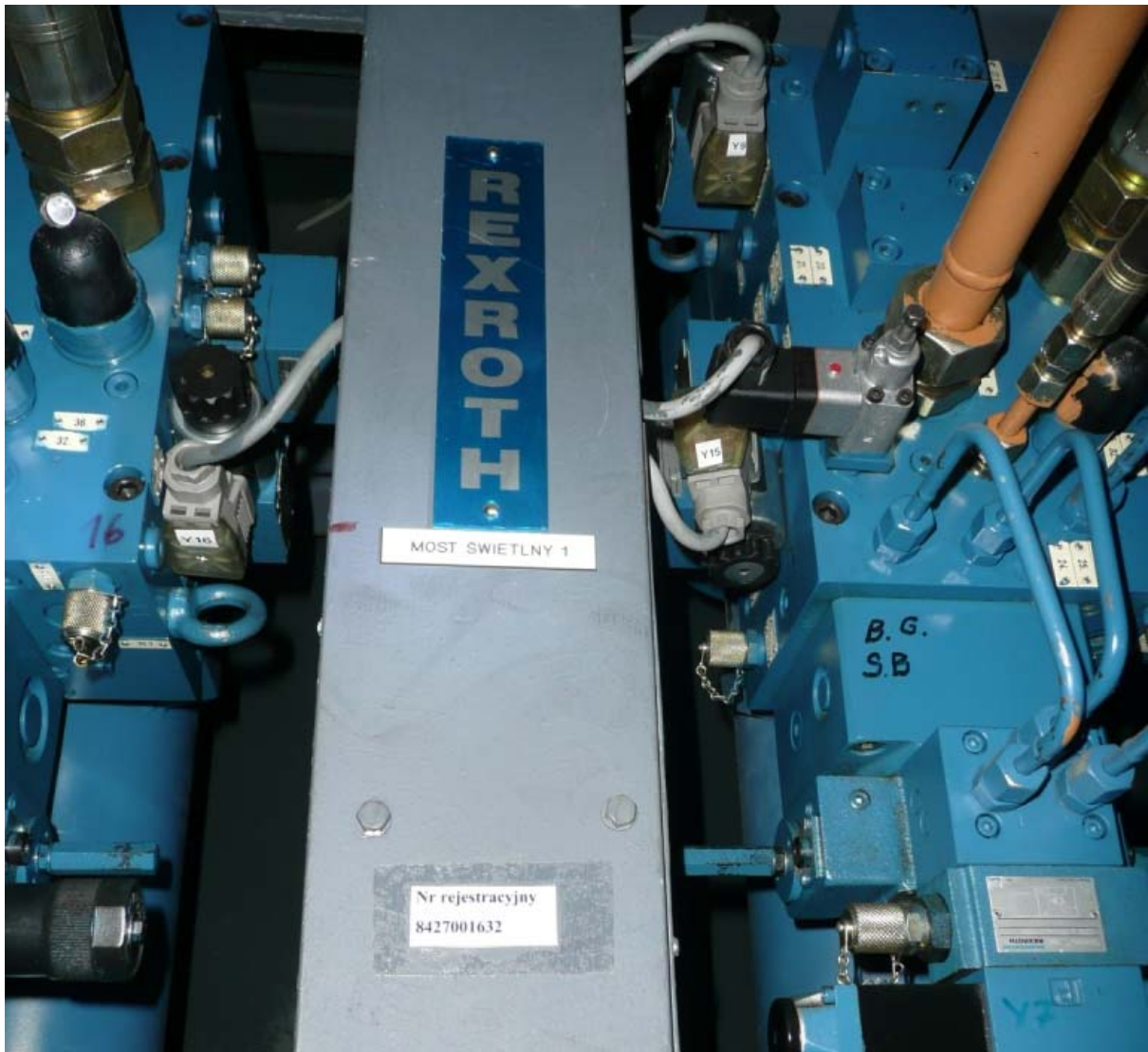
Fot. 3. Widok ogólny na przyłącza hydrauliczne mostu świetlnego 1.
