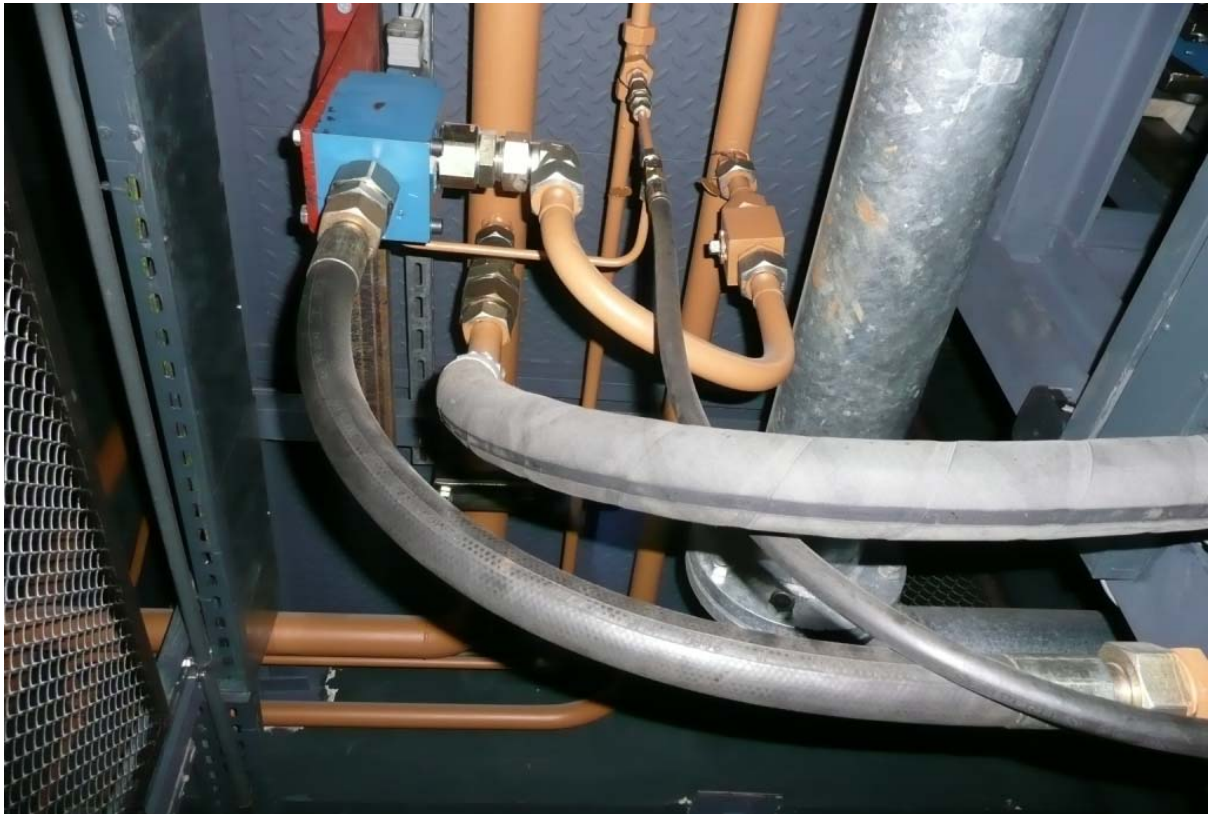
Fot. 11. Końcówki elastycznych przewodów hydraulicznych mostu świetlnego 3. (zakończenie górne)
